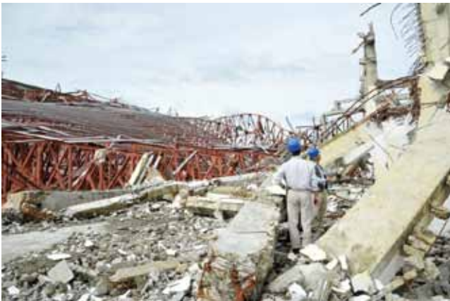
図2 レイテコンベンションセンターの屋根倒壊(2013)
